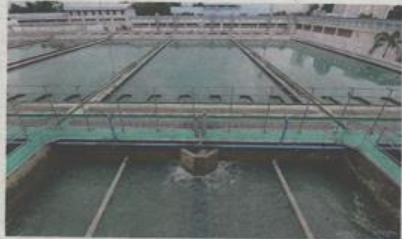
Loji Rawatan Air Sungai Semenyih terpaksa henti tugas akibat pencemaran bau dikesan di Stesen Pam Air Mentah Jenderam Hilir pada jam 11.10 pagi Selasa.
