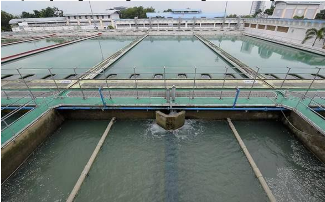
Loji Rawatan Air Sungai Semenyih
